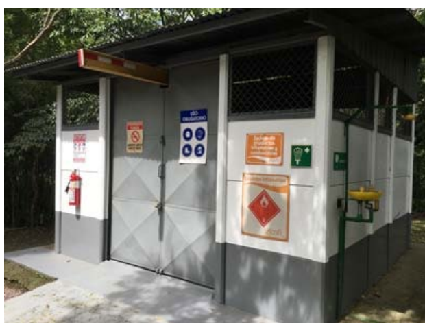
Bodega de Productos Inflamables e Hidrocarburos de Planta Hidroeléctrica Belén.
