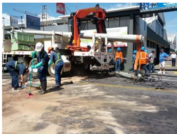
Atención de derrame de aceite dieléctrico.
